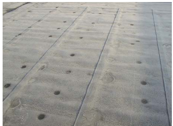
Thermische bruggen van de mechanische bevestigingen van de isolatie
